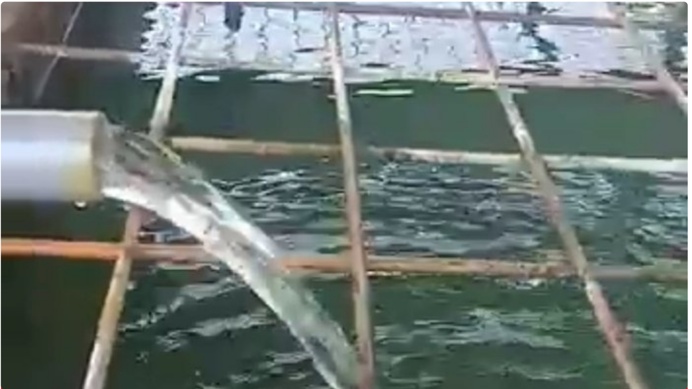
Aliran Air di SMAN CMBBS Pandeglang, Terlihat Deras dan Melimpah Ruah di Penampungan Bak Utama, Rabu (16/8/2023)
