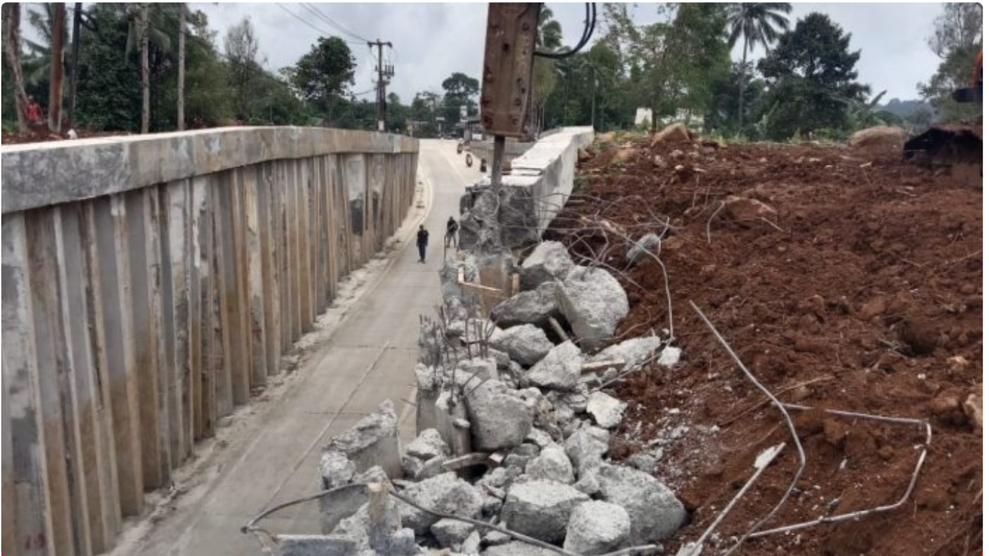
Diduga Proyek Gagal Kontruksi
